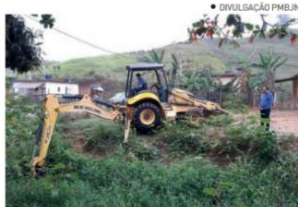
LIMPEZA do canal deve durar toda a semana
